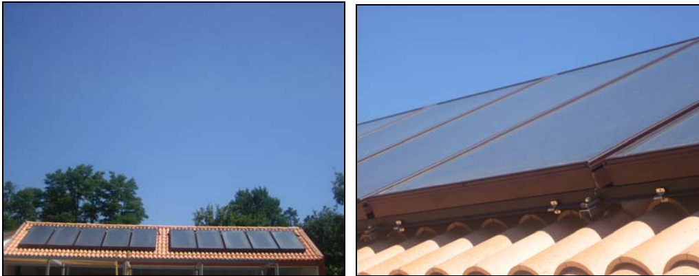
PANELES DE ALTO RENDIMIENTO EN PISCINA CUBIERTA
