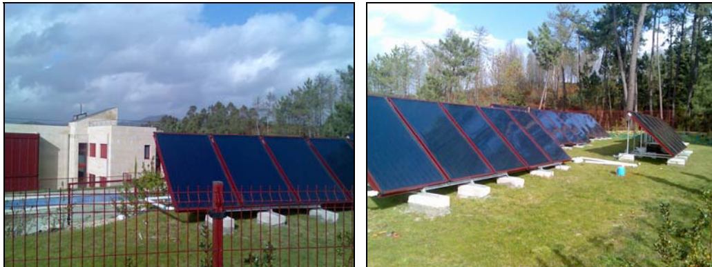
PANELES DE ALTO RENDIMIENTO EN ZONA AJARDINADA
