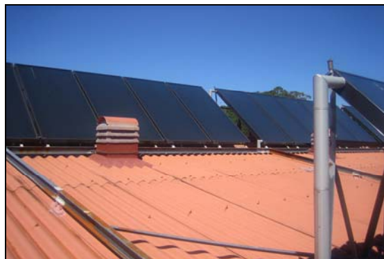
COLECTORES SOBRE CUBIERTA
